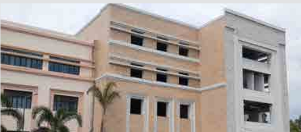
एसआईएफ एक्सटेंशन: संरचना पूर्ण, पेंटिंग, एल्युमिनियम कार्य, फॉल्स सीलिंग कार्य, स्वच्छता कार्य, एचवीएसी और विद्युत कार्य जैसे परिष्करण कार्य प्रगति पर हैं। लगभग 75.25 प्रतिशत भवन निर्माण कार्य पूर्ण हो चुका है।
