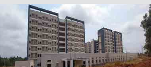
बालक छात्रावास-3: लगभग 75 प्रतिशत स्ट्रक्चरल कार्य पूर्ण तथा फिनिशिंग कार्य प्रगति पर है। लगभग 93.50% भवन निर्माण कार्य पूर्ण
