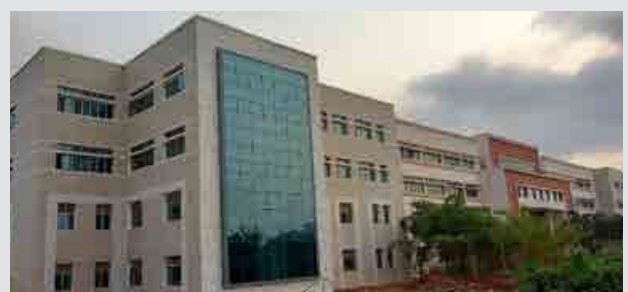
एसईएस एक्सटेंशन : मौजूदा भवन के दोनों ओर का स्ट्रक्चर तैयार कर फिनिशिंग का काम प्रगति पर है। लगभग 87.60 प्रतिशत भवन निर्माण कार्य पूर्ण हो चुका है।
