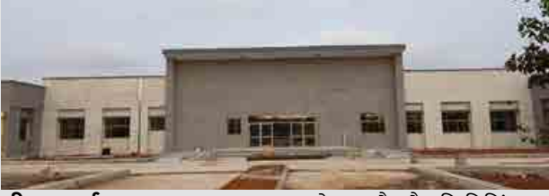
सीआरआईएफ: स्ट्रक्चरल काम पूरा हो गया है और फिनिशिंग का काम प्रगति पर है। लगभग 92.69 प्रतिशत भवन निर्माण कार्य पूर्ण हो चुका है।
